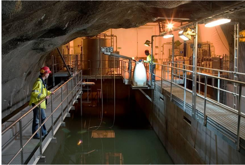
Figur 6: Södra Länkens VA-station. (Vid den bortre änden av sedimentationsbassängen syns oljeskimmern samt behållaren med natriumhydroxid.)
